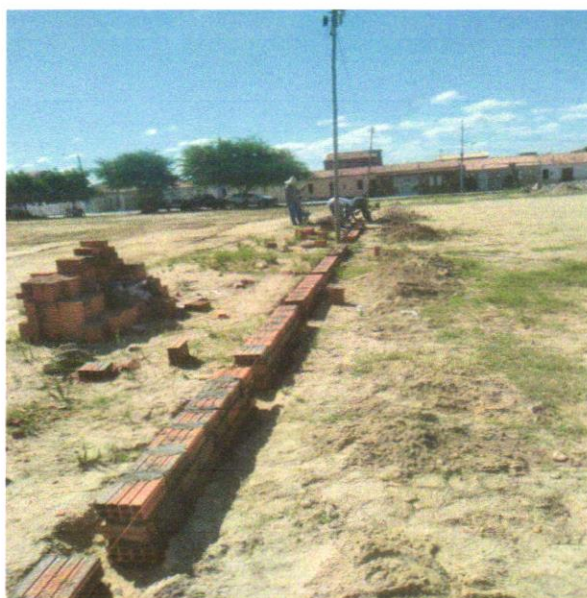
Foto 01 – ALVENARIA DE VEDAÇÃO DE BLOCOS CERÂMICOS FURADOS NA VERTICAL DE 9X19X39 CM (ESPESSURA 9 CM) E ARGAMASSA DE ASSENTAMENTO COM PREPARO EM BETONEIRA. AF_12/2021
